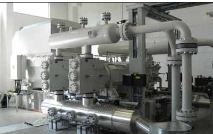
Abb. 7: Verdichter 3/Foto: E.ON Hanse AG
