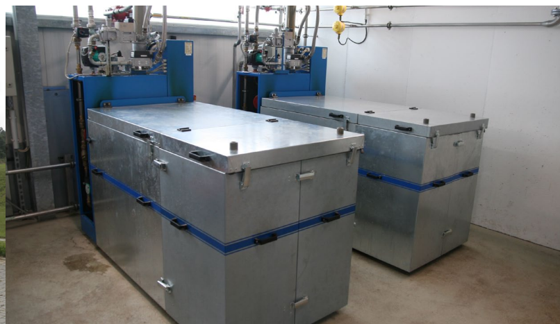
Bild 5.5: BHKW-Anlage der Kläranlage Radegast (Elektrische Leistung 2 x 25 kW)
