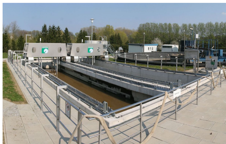
Bild 5.8: Vorklärung der Kläranlage Boltenhagen
