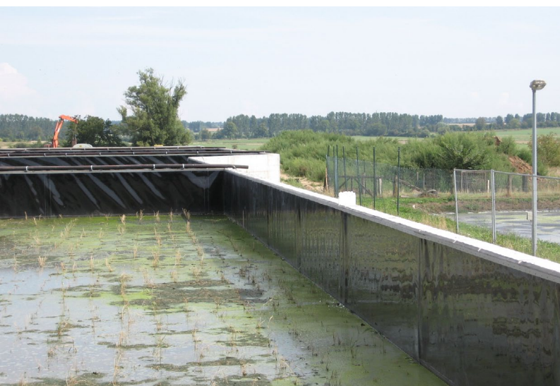
Bild 5.9: Inbetriebnahme einer Klärschlammvererdungsanlage (Kläranlage Dargun)
